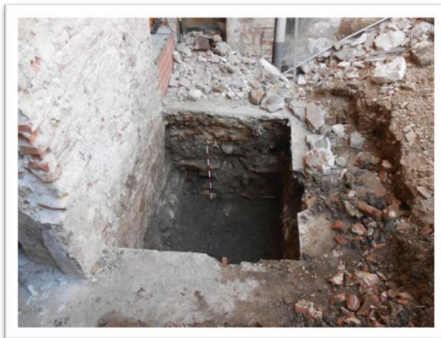
Imatge 2. Fossat per a la col·locació de la maquinària de filtratge de la piscina al pati de la finca
